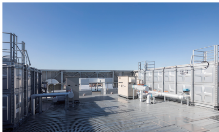
屋上給水設備
